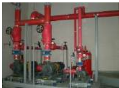
BƠM CHỮA CHÁY
